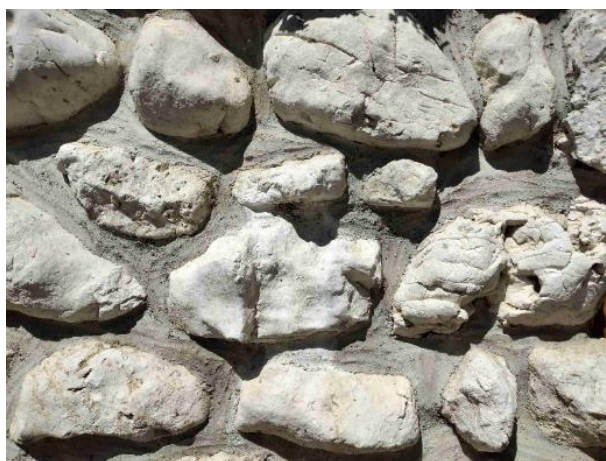
Fig. 20 – Particolare della muratura di sassi. Sulla malta cementizia che li tiene assemblati, l'impronta lasciata dalla cazzuola. ERB , 17/05/2022.
