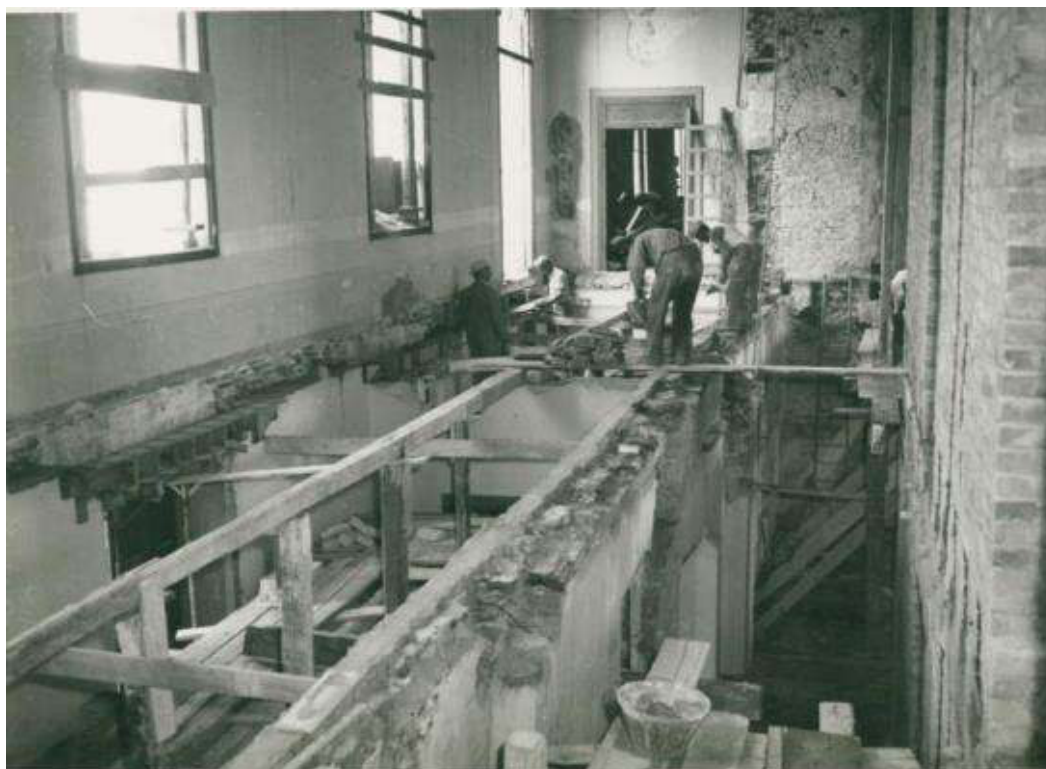
Figura 45: Palazzo Vescovile durante i lavori del 1959-1960. (Archivio dell'ufficio amministrazione della Curia Vescovile di Treviso)
