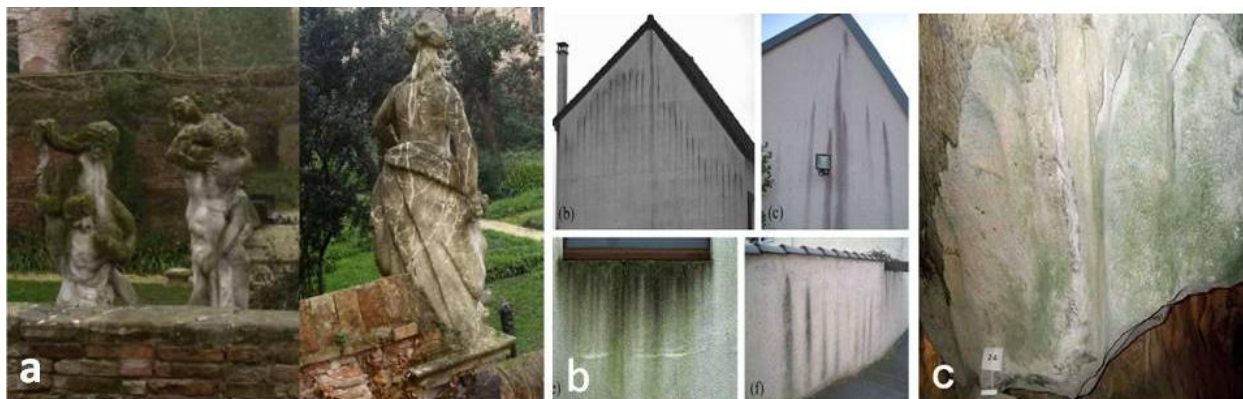
Figura 1 Colonizzazione biologica su differenti tipi di materiali lapidei: a) statue di marmo colonizzate da muschi e licheni, b) differenti facciate di edifici con colonizzazione algale; c) biofilm di alghe e cianobatteri su parete in calcare.
