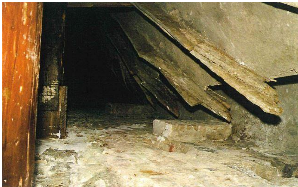
Fig. 33. Degrado degli elementi lignei del controsoffitto dell'aula centrale del Museo San Paolo, Monselice.
