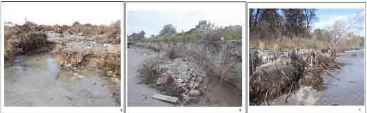
Figura 65. Erosione nella cassa di colmata B. Area Nord (A), centrale (B) e Sud (C). Fotografie del 4 novembre (A), del 16 giugno (B) e del 16 luglio 2014 (C).
