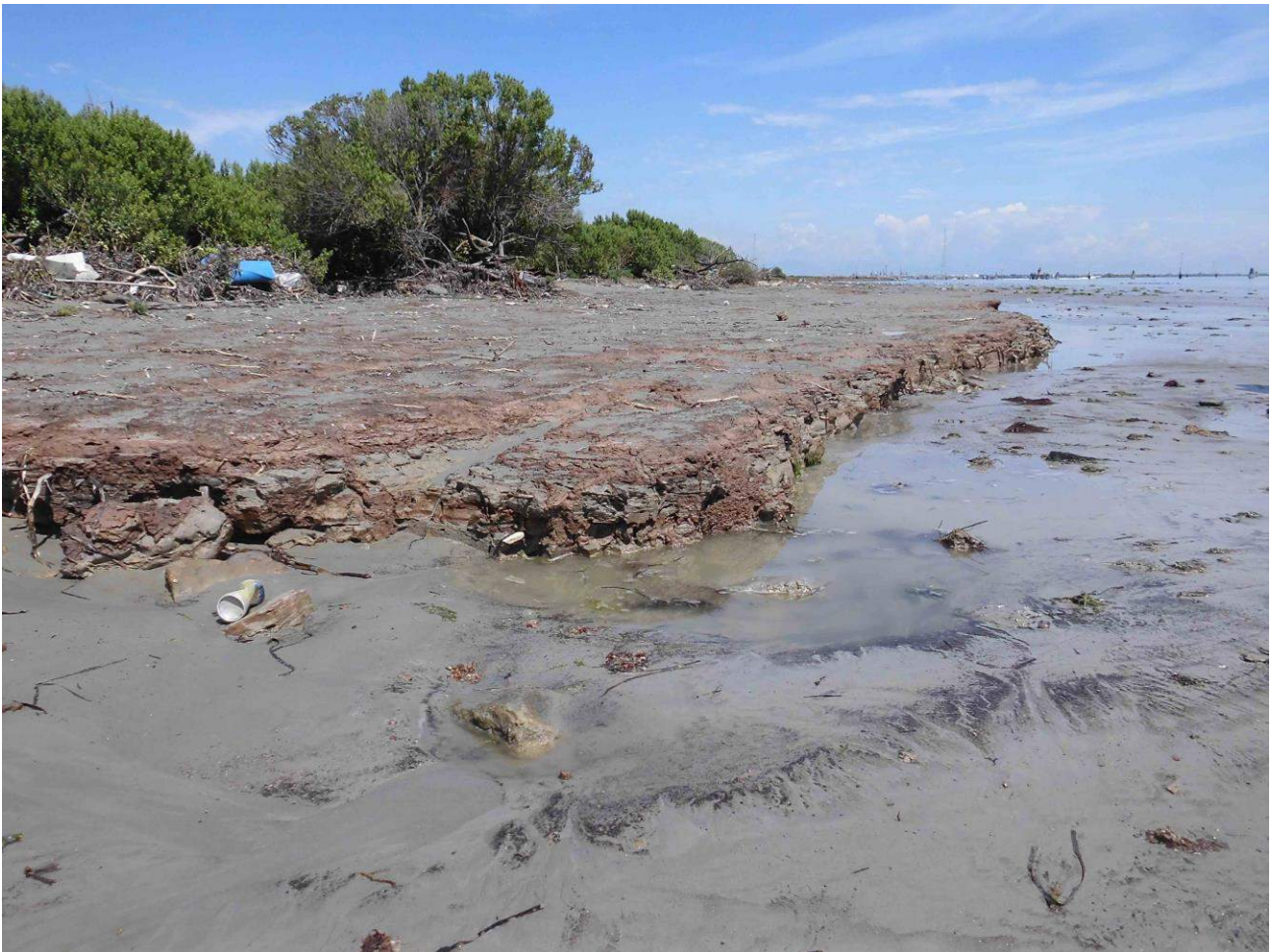
Figura 95. Linea di riva in erosione nell'area Nord (punto di riferimento numero 8) della cassa di colmata B. Fotografia del 16 luglio 2014.
